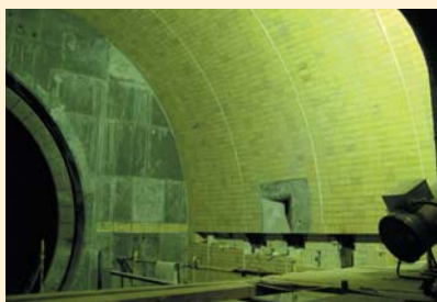
Футеровка головки печи на ОАО Мордовцемент
